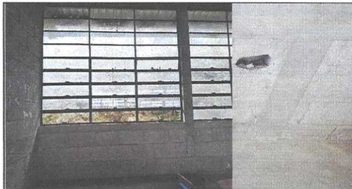
Foto 4: observamos de la parte de atrás del aula de primer grado las ventanas sin vidrios, paredes rotos
