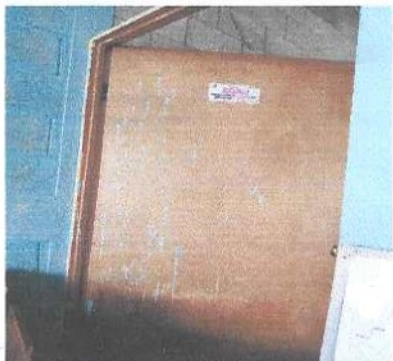
Foto 1: Esta puerta esta deteriorado, esta ubicada en Direccion
