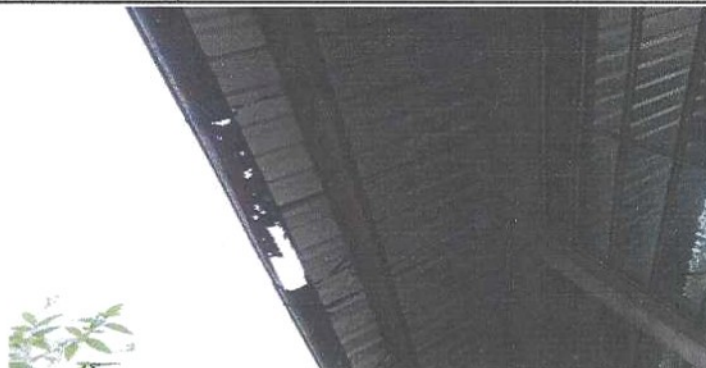
Foto 2: como se puede observar las canaletas esta oxidado y rotas parte de atrás y cunetas en mal estado
