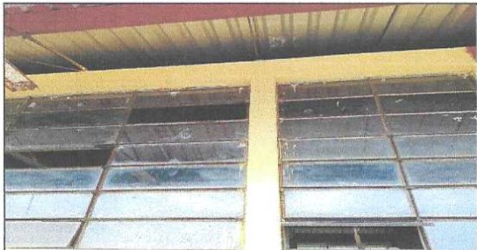
Foto 3: Las ventanas ya no tiene vidrios y necesitamos mantenimiento de las ventanas
